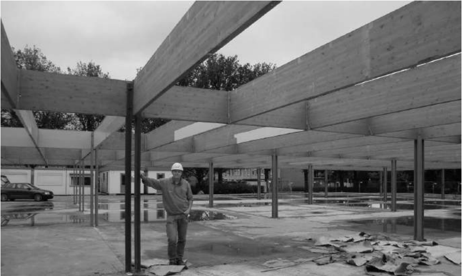
Uitvoerder Harry Bomers van bouwbedrijf Haafkes onder het skelet dat blijft staan en onderdeel gaat vormen van het nieuwe gebouw.
